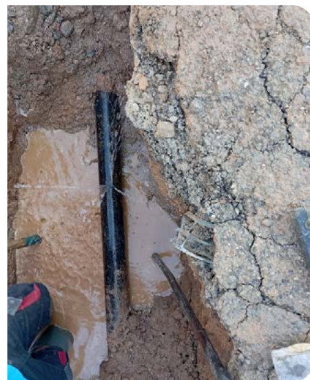
Fuite Chemin de Vinchannes
